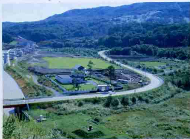
◎川上総合公園 市民が大勢集って楽しめる大規模な総合公園を造成中 です。既に多目的広場が完成し、今年開放する予定です。
